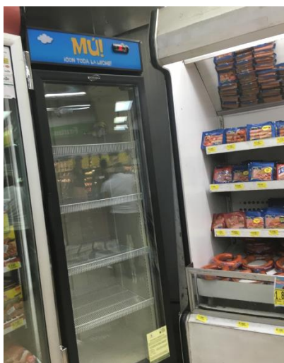
Figura 28: Cámara de refrigeración Mú, Mega súper Alajuela Centro
