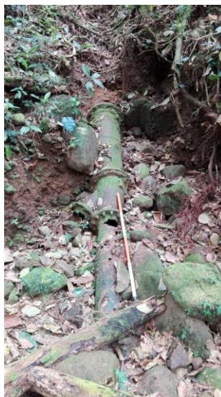
Figura 22. Vista de la tubería metálica de la planta hidroeléctrica
