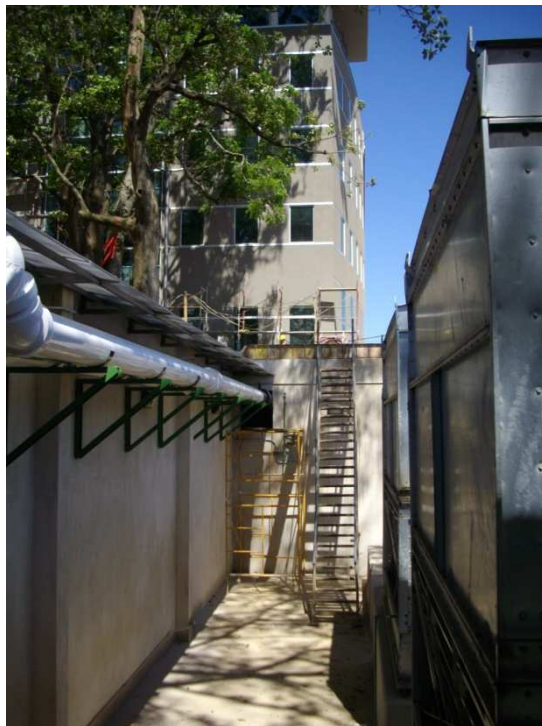
Imagen 3.11: Entrada tuberías a bancos de hielo enterrados
