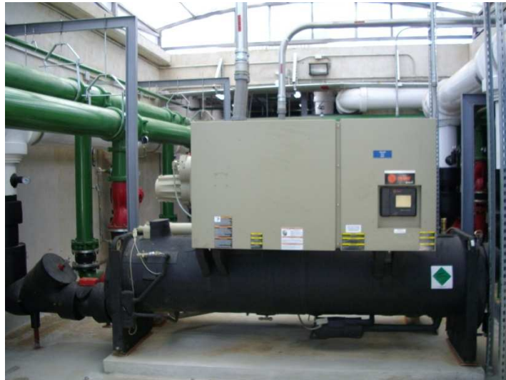
Imagen 3.9: Chiller enfriado por agua
