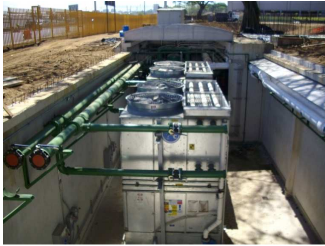
Imagen 3.10: Torres de enfriamiento
