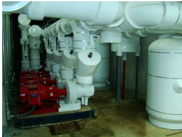
Imagen 3.12: Bombas de agua helada
