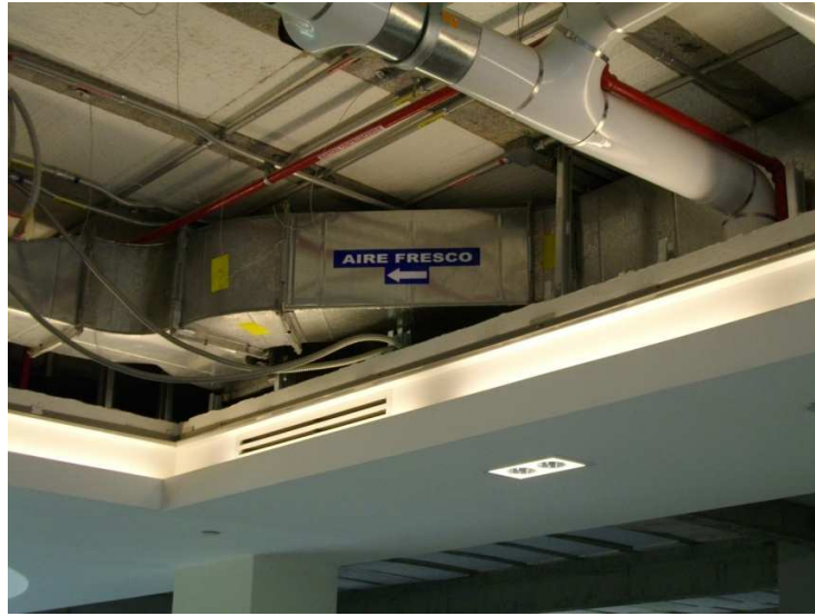
Imagen 3.6: Ducto de aire fresco y tuberías Vestíbulo Nivel 1, Edificio 1
