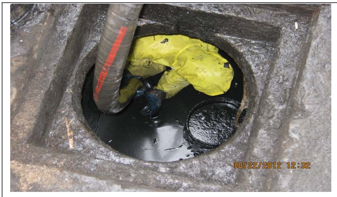
Figura 1.4 Fotografía de limpieza de trampas de gras
