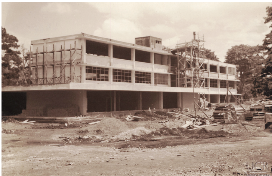
Fotografía 3.3: Construcción del edificio de la Escuela de Ciencias Económicas y Sociales de la UCR en 1959. AUROL, UCR.
