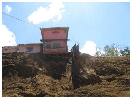
Fotografía 9-2.12 Consecuencias del terremoto del 8 de enero 2009, Cinco Esquinas
