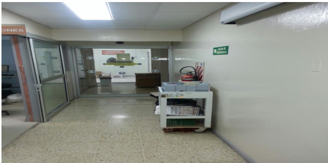
Figura # 3. Vista lateral del “Fortín” del servicio de medicina nuclear del Hospital San Juan de Dios, colocado en medio pasillo, sin llave ni protección alguna.
