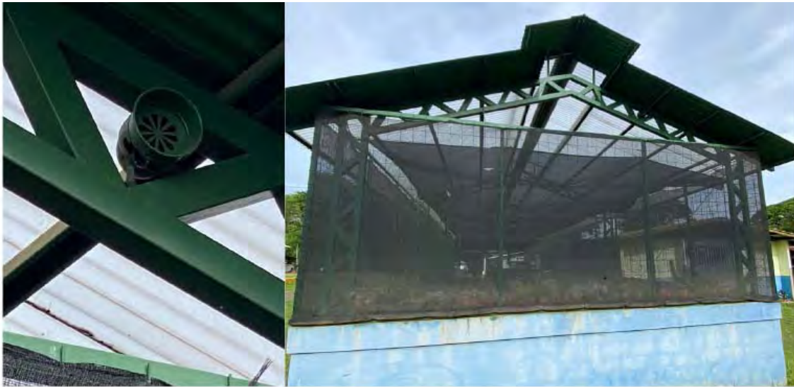
Actual sirena ubicada en el primer invernadero construido en 1969
