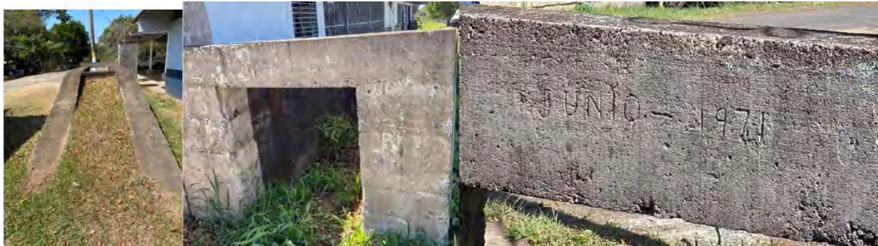
Rampa para mantenimiento de vehículos elaborada en junio de 1971.
