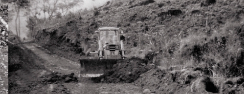
Figura 6 Equipo de la FAO construyendo un camino, llegando al río Platanarcito hasta el río Blosi. Fotografía: autoría sin información. Salitre, Buenos Aires, 1967. LEMEBV, No. 317.
