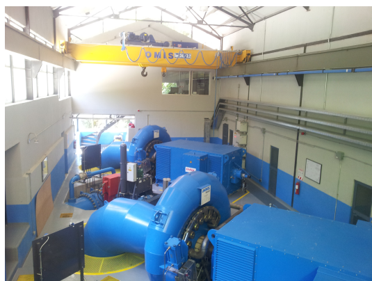
Ilustración 34. Planta hidroeléctrica Jorge Manuel Dengo
