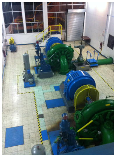
Ilustración 32. Planta hidroeléctrica Jorge Manuel Dengo
