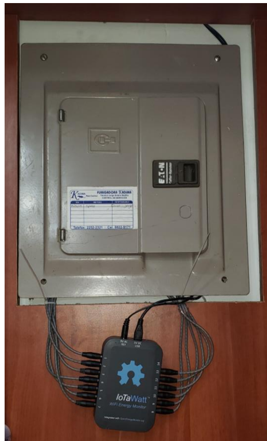
Figura 33. Instalación del IoTaWatt con la tapa del tablero.
