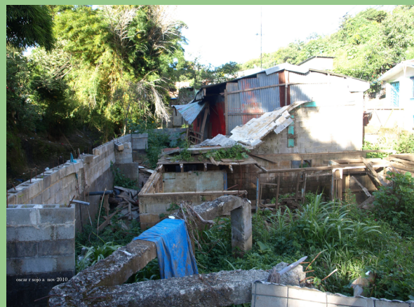
Figura 2. Efectos de la inundación en el barrio Fátima de Santo Domingo de Heredia, provocada por el desbordamiento del río Bermúdez en julio de 2010. Foto de Oscar Sojo.
