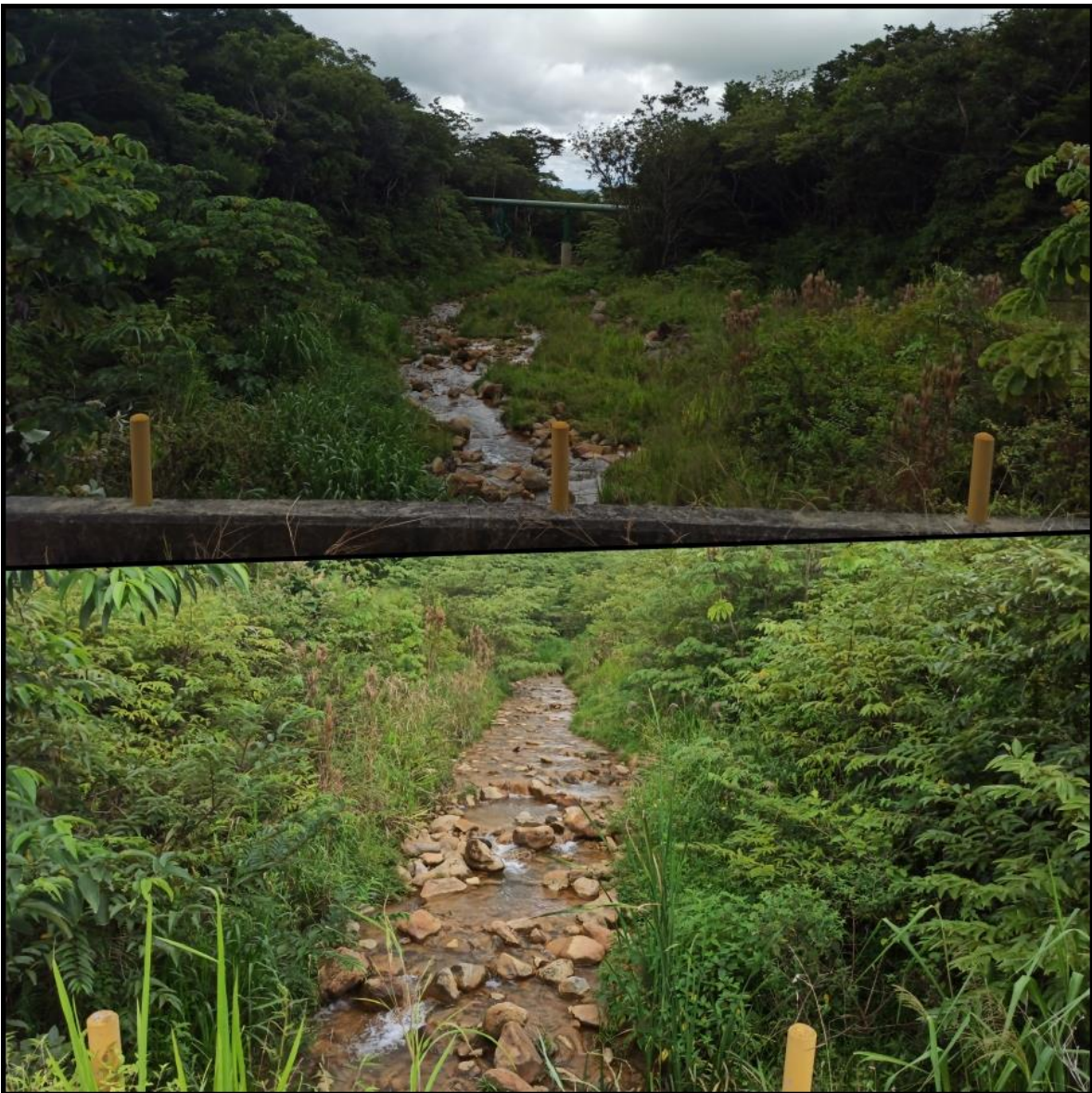
Figura 9-19 Alcantarilla en cauce de Quebrada Hornillas en la zona alta.
