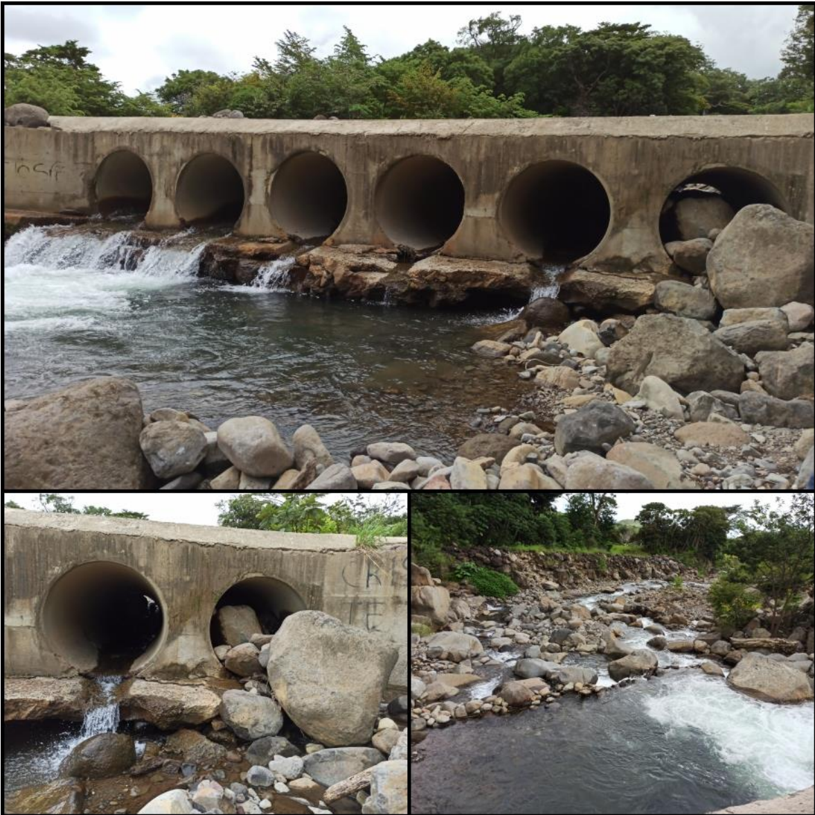
Figura 9-15 Alcantarilla en la parte alta del modelo de Cuipilapia, fotos tomadas aguas debajo de la estructura.
