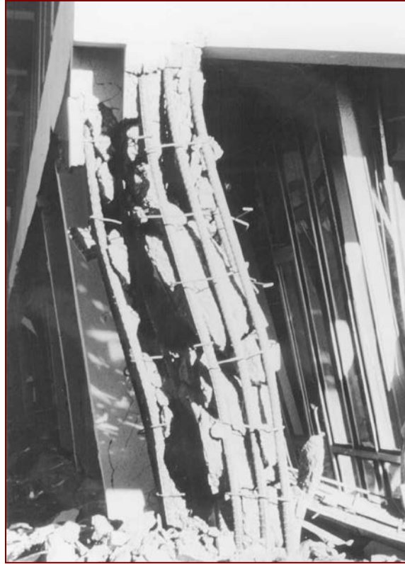
Figura 9–6 Columna con aros destruida durante el terremoto de San Fernando, CA 1971. (Fotografía cortesía de NIST)
