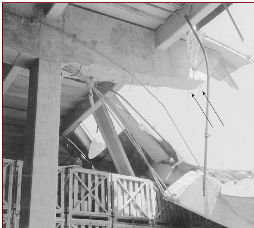
Figura 5–2 Falla de cortante: Bodega de la Fuerza Aérea de U.S.A. en Shelby, Ohio. Colapso total de un techo de 300 m 2 , 20 bodegas similares en uso. Resultado: ACI 318-56 pide refuerzo del alma en zona de punto de inflexión en vigas continuas. (Fotografía cortesía de C. P. Siess, agosto 1955)
