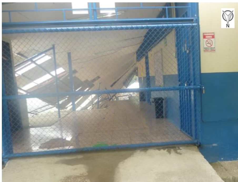
Figura 8. Espacios escolares dañados por la emergencia. Fuente: Camacho, V, 2017.
