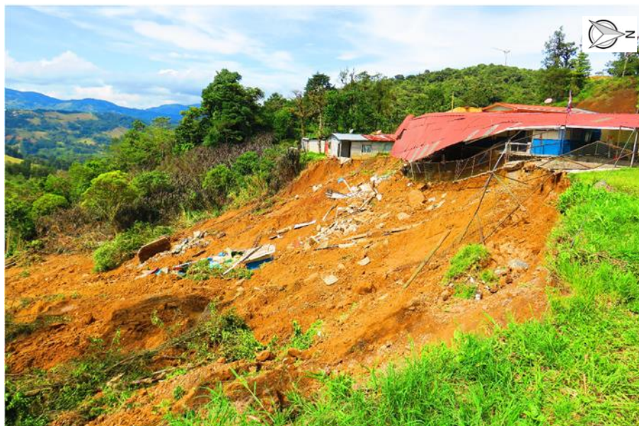
Figura 5. Vista del deslizamiento en el terreno de la Escuela Casamata. Fuente: Mora, 2017.
