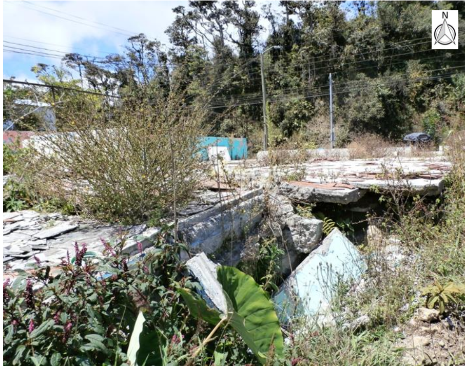
Figura 25. El terreno resultó muy dañado por el deslizamiento. Fuente: Fotografía propia, 2019.
