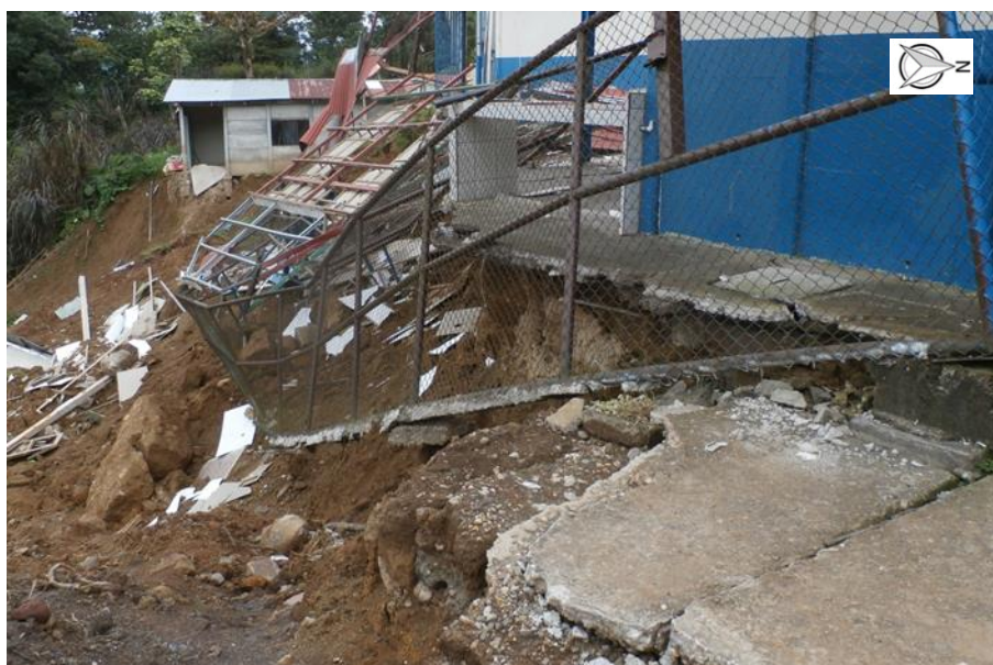
Figura 6. Ruptura de la infraestructura sobre la corona del deslizamiento. Fuente: Fotografía propia, 2017.
