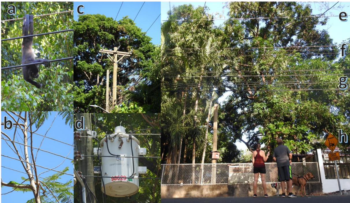
Figura 7. Infraestructura eléctrica presente en Playa Hermosa, Guanacaste. a. cableado aislado, b. cableado desnudo, c. cableado trifásico, d. transformador, e. línea eléctrica primaria, f. línea eléctrica secundaria, g. cableado telefónico, fibra óptica y televisión.
