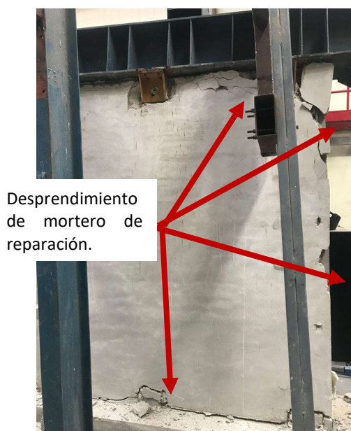
Figura 82. Muro fallado h/l = 1 , pared reparada 1.
