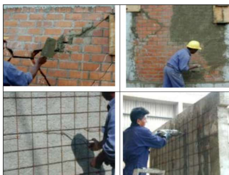
Figura 7. Reforzamiento con malla electrosoldada (Tomada de Capítulo V (T-ESPE-025410-5), “Técnicas de reforzamiento de mampostería”, A. San Batolomé y A. Castro).
