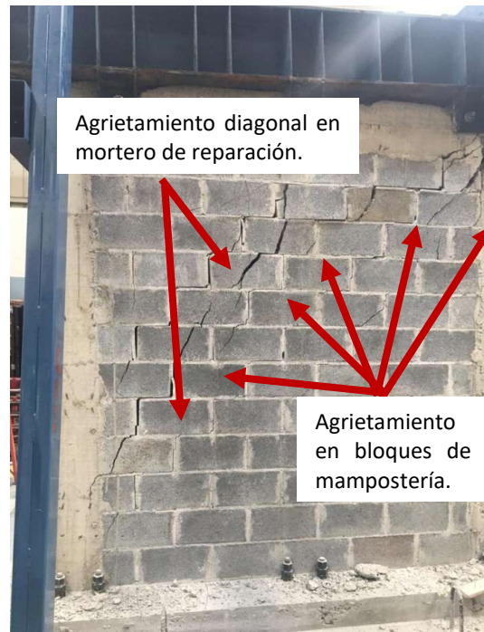
Figura 97. Agrietamiento del muro h/l = 1 , pared reparada 2.
