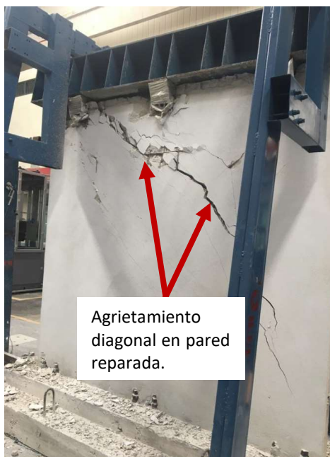
Figura 98 Agrietamiento del muro h/l = 0.5 , pared reparada 2.
