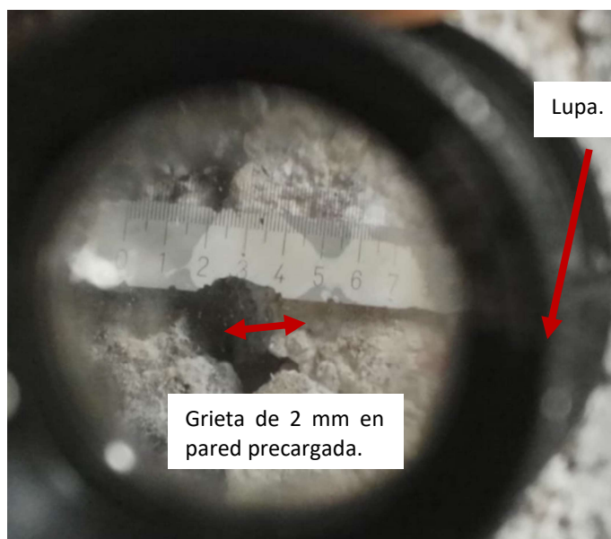
Figura 72. Abertura de grietas en mm, pared precargada 1 h/l = 1.
