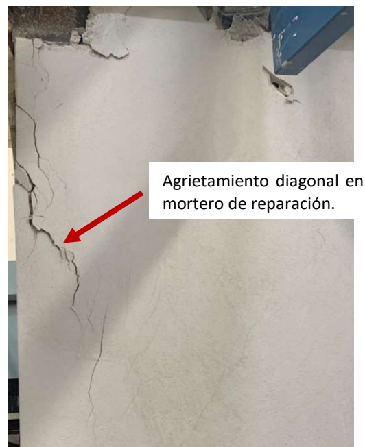
Figura 93 Agrietamiento del muro h/l = 0.5 , pared reparada 2.
