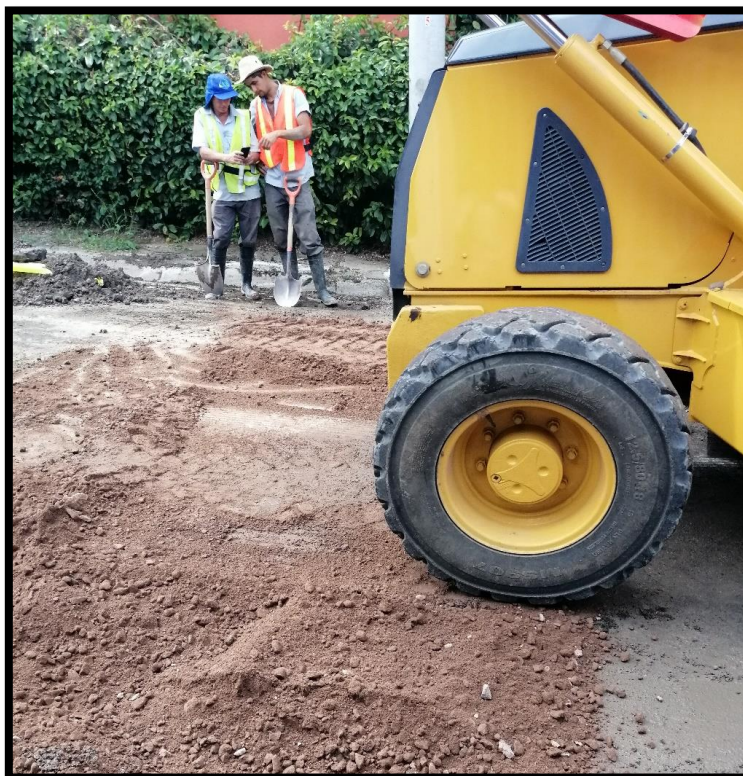
Figura 4-36. Compactación inadecuada del material de relleno de zanja
