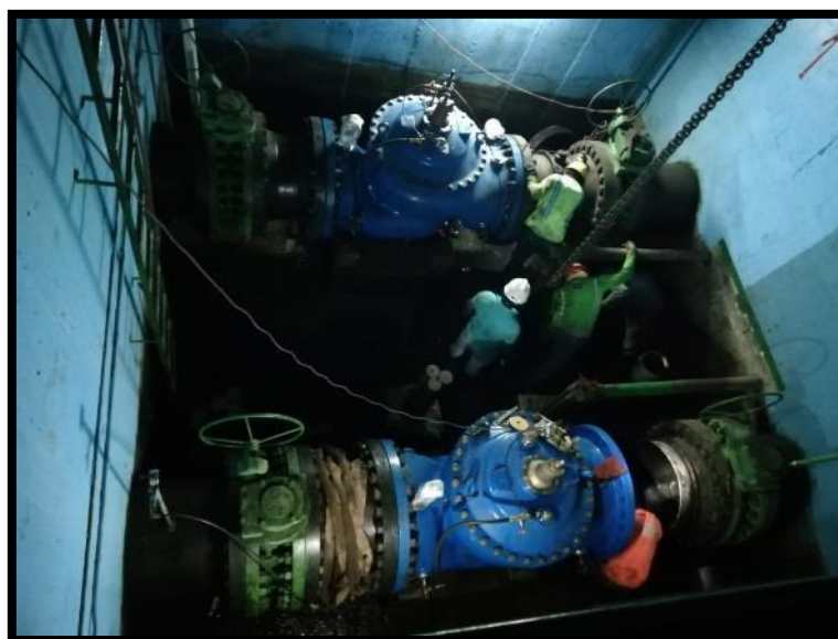
Figura 2-9. Válvulas 900 mm en tubería de conducción del sistema ME-A-01 Tres Ríos
