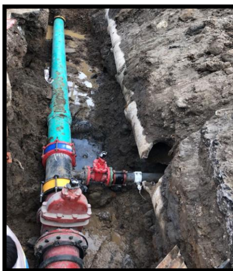
Figura 2-11. Tubería de distribución del Acueducto Metropolitano
