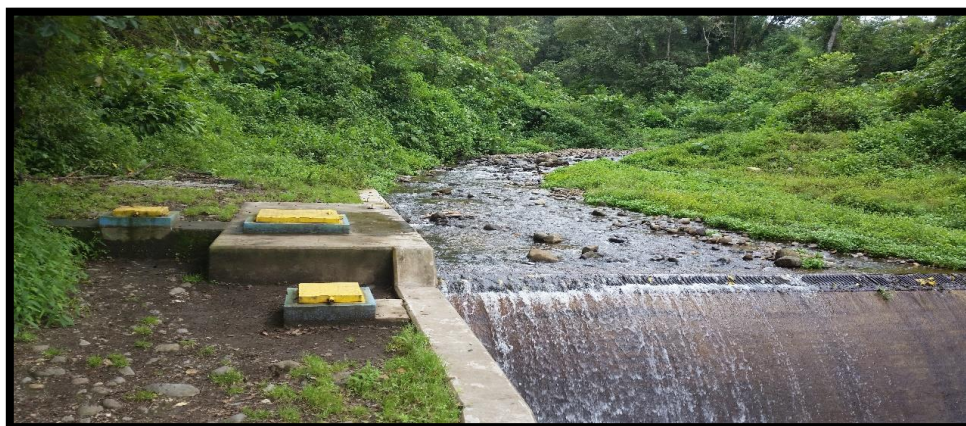
Figura 2-2. Toma Superficial Río Virilla 2 del sistema ME-A-14 San Rafael de Coronado, Acueducto Metropolitano
