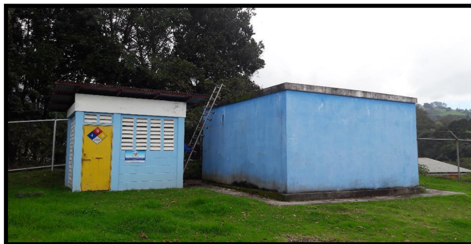
Figura 2-5. Estación de desinfección del Tanque Vista de Mar, sistema ME-A-28 Vista de Mar, Acueducto Metropolitano
