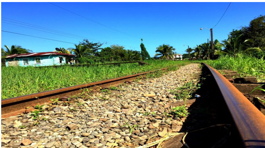
Ilustración 100. Vías férreas en mal estado. Fotografía tomada 2016.
