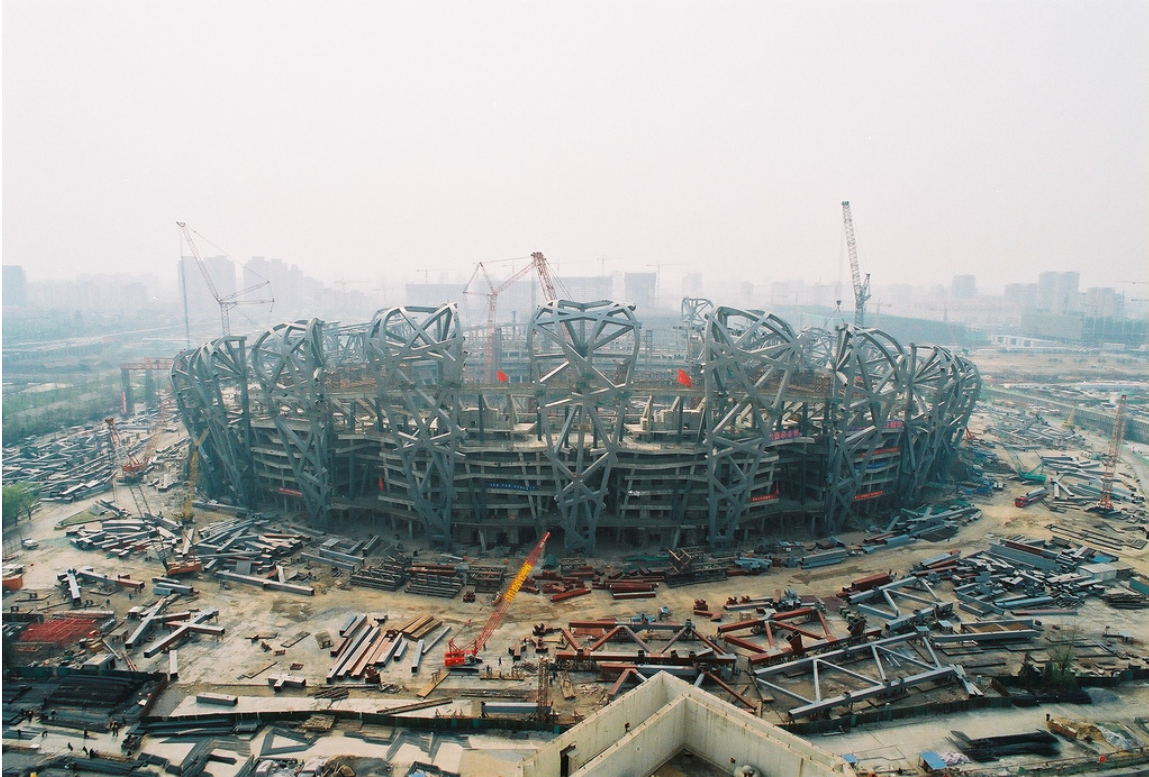
Fig. 11_Montaje de las 24 columnas compuestas. La estrategia de montaje general adoptada por Arup fue maximizar la prefabricación y minimizar el montaje in situ (Lam & Lam 2019)
