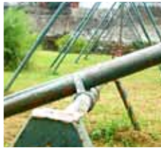
"Play" en mal estado
