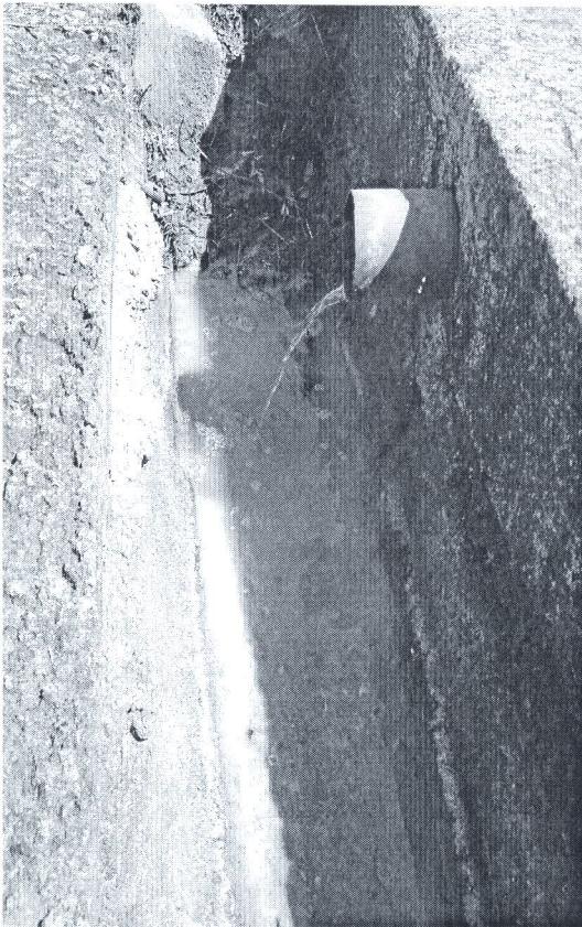
Foto 9. Descarga de aguas residuales en el alcantarillado pluvial, Distrito de Santo Domingo.
