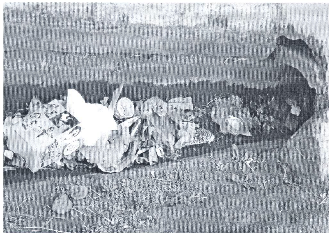
Foto 5. Basura en el alcantarillado pluvial, Distrito de Santo Domingo.
