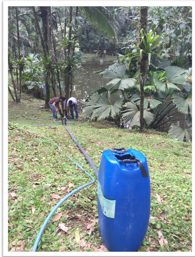
Figura 7. Tanque de captación e instalación en campo de ariete hidráulico
